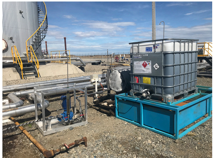
Skid de inyección química
